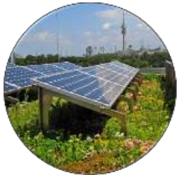
PV + sedum op alle daken
